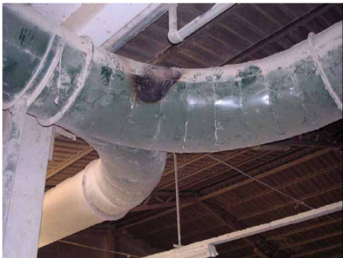
รอยไหม้ภายในท่อดูดฝุ่นจากเครื่อง Sander Machine
