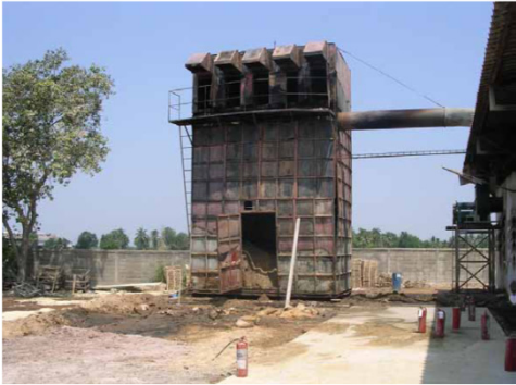
สภาพความเสียหายห้องเก็บฝุ่นไม้ (Dust Collector)
