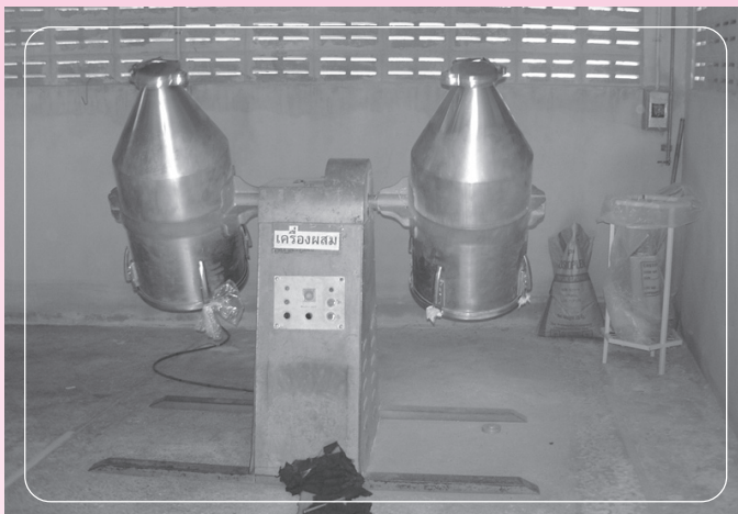
รูปที่ 14 เครื่องผสมเม็ดพลาสติกต้องกำหนดพื้นที่หรือแนวเขตการทำงาน เพื่อป้องกันการเหวี่ยง กระแทกถูกพ่นกงาน
