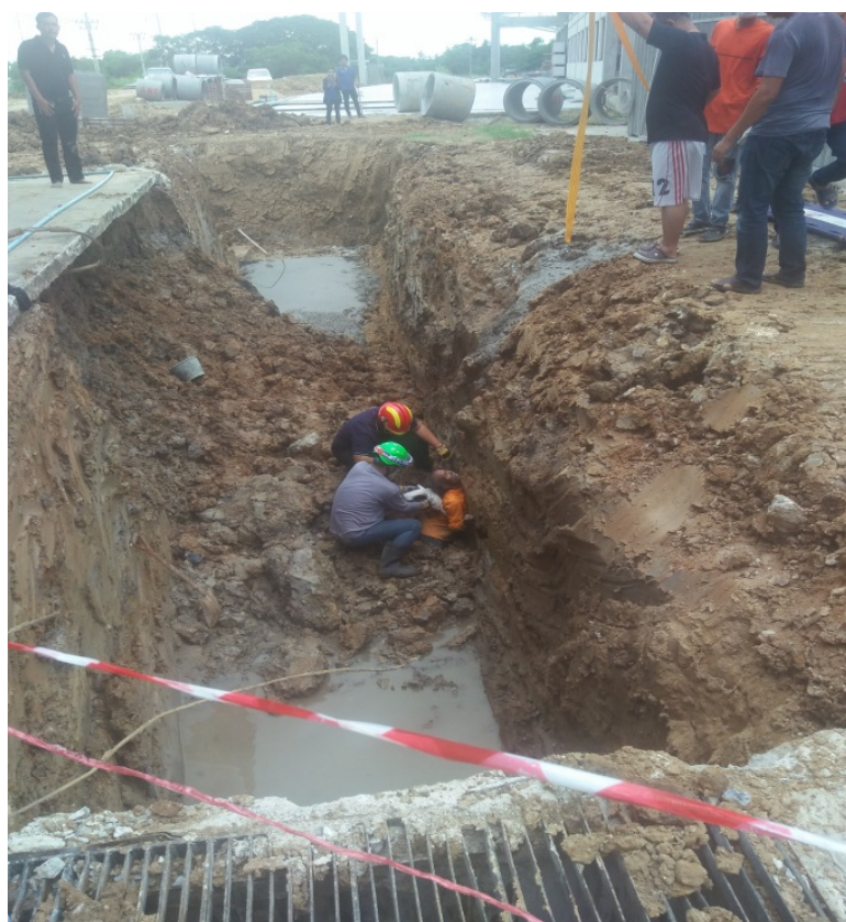
รูปที่ ๙ ภาพดินได้พังทลายทับร่างลูกจ้างจากด้านหลังเสียชีวิต
