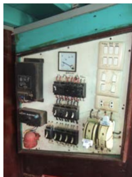
ภาพที่ ๙ แผงควบคุมไฟฟ้าบนเรือ
