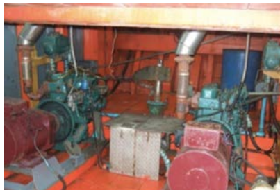
ภาพที่ ๒ เครื่องกำเนิดไฟฟ้าภายในห้องเครื่องยนต์
