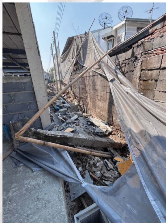
ภาพที่ ๒.๓.๕ การติดตั้งผ้าใบก่อสร้างเพื่อป้องกันวัสดุกระเด็นไปโดนบ้านเรือนประชาชน แต่ไม่มั่นคงแข็งแรง เพียงพอที่จะป้องกันกำแพงคอนกรีตล้มใส่ผู้ปฏิบัติงานได้
