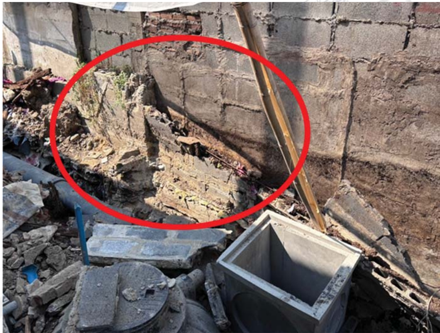
ภาพที่ ๒.๓.๔ ลักษณะการติดตั้งกำแพงคอนกรีตซ้อนทับกัน ๒ ชั้น (กำแพงฝั่งที่ล้มมีอายุการใช้งานมากกว่า ๒๐ ปี)
