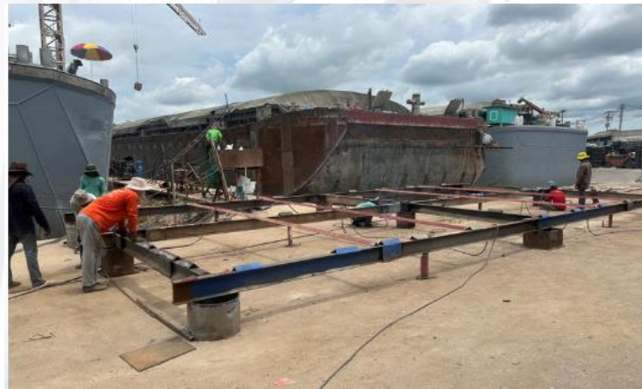
รูปที่ ๑๔ แสดงการวางคานโดยใช้เหล็ก I-Beam และเชื่อมประกอบเหล็กฉาก
