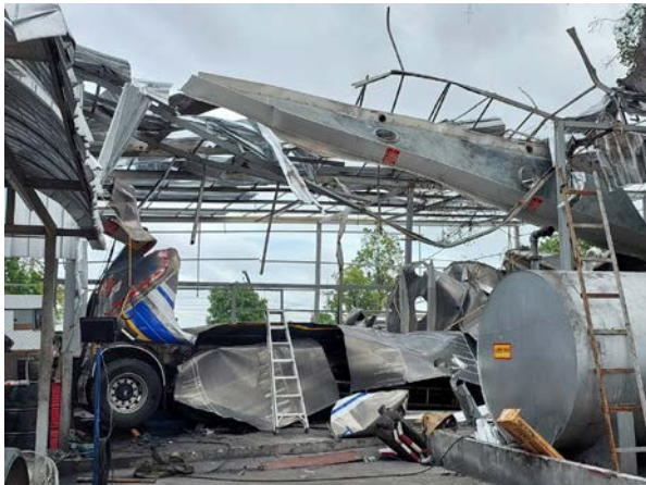
ภาพที่ ๓ ความเสียหายที่เกิดขึ้นกับถังบรรจุน้ำมันและพื้นที่
