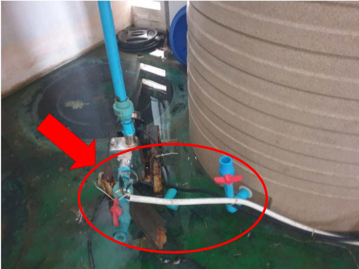
ภาพที่ ๑ ท่อที่โดนถังน้ำทับหักจุดที่สารแอมโมเนียรั่วไหลออกมา
