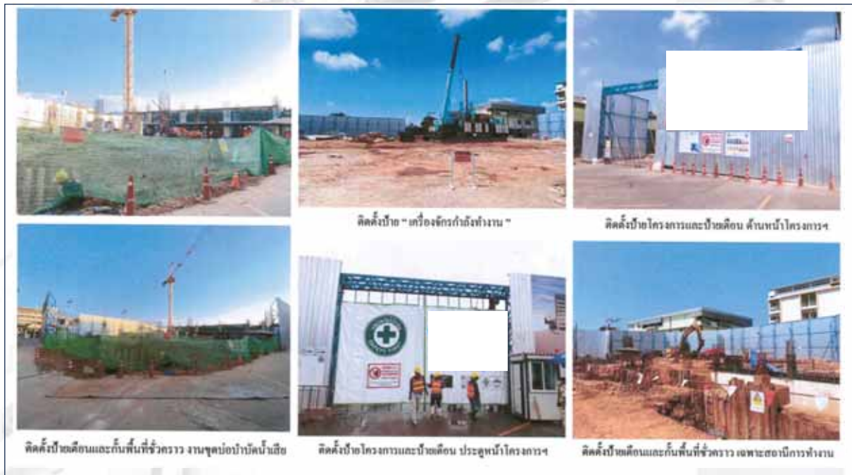
ภาพที่ 13 แสดงกำหนดบริเวณเขตก่อสร้าง และกำหนดเขตอันตรายในเขตก่อสร้าง
