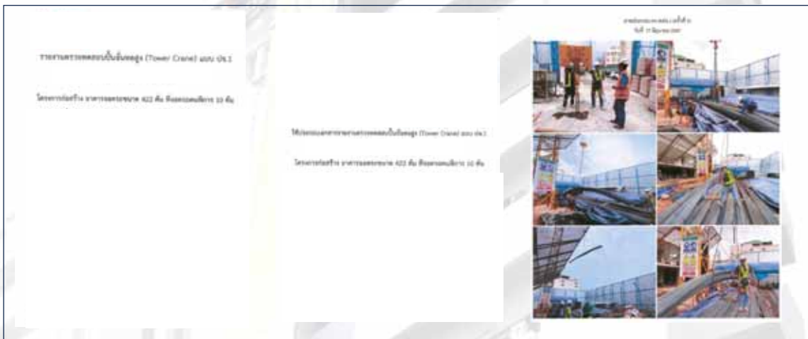
ภาพที่ 11 แสดงรายงานการตรวจสอบปั้นจั่นหอสถูง (ปจ.1) ของโครงการฯ
