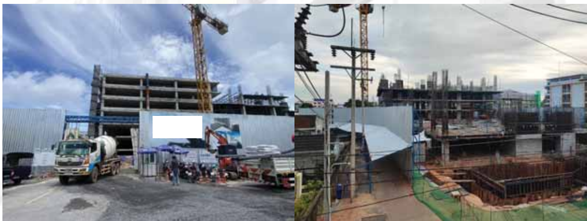
ภาพที่ 3 สภาพแวดล้อมพื้นที่โครงการก่อสร้างอาคารโรงจอดรถโรงพยาบาล ท
