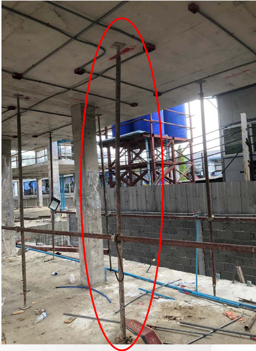
ภาพที่ ๒.๕.๒ ภาพบริเวณพื้นที่การก่อสร้าง (ต่อ)
