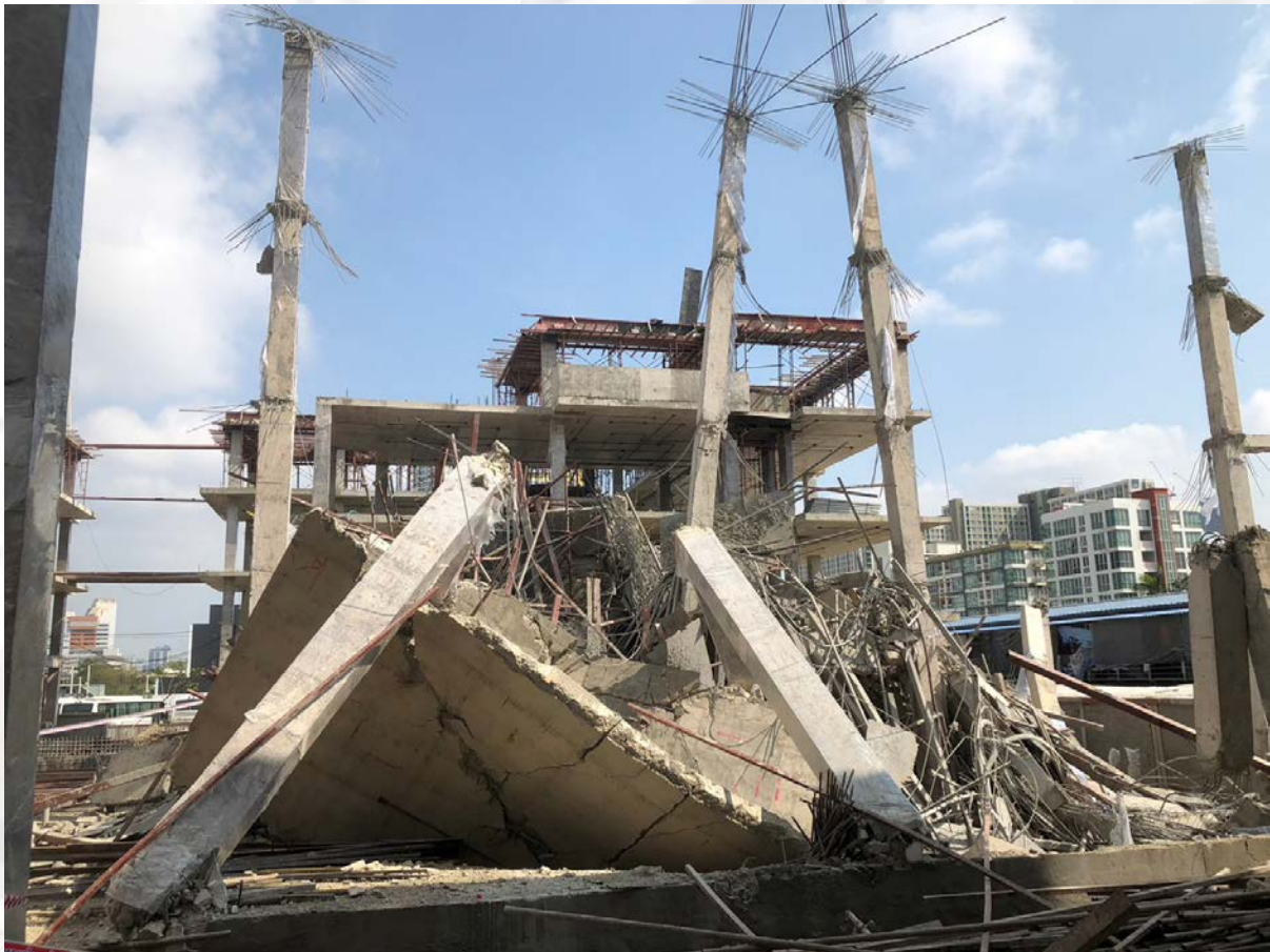
ภาพที่ ๒.๕.๑ ภาพอาคารที่กำลังก่อสร้างถล่ม
