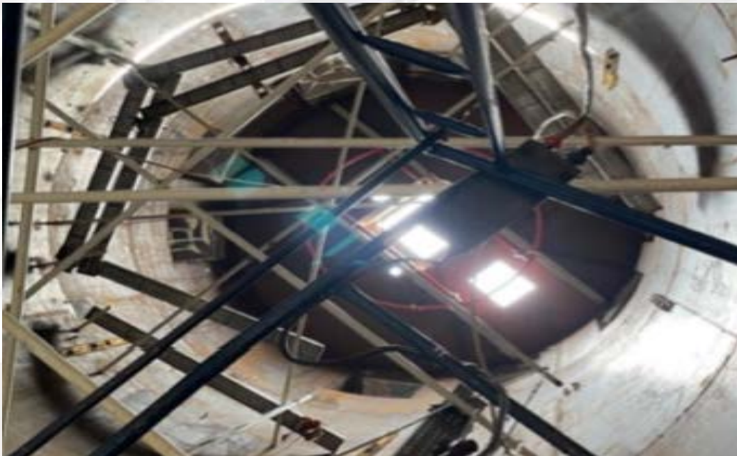
นั่งร้านขณะเกิดเหตุ
