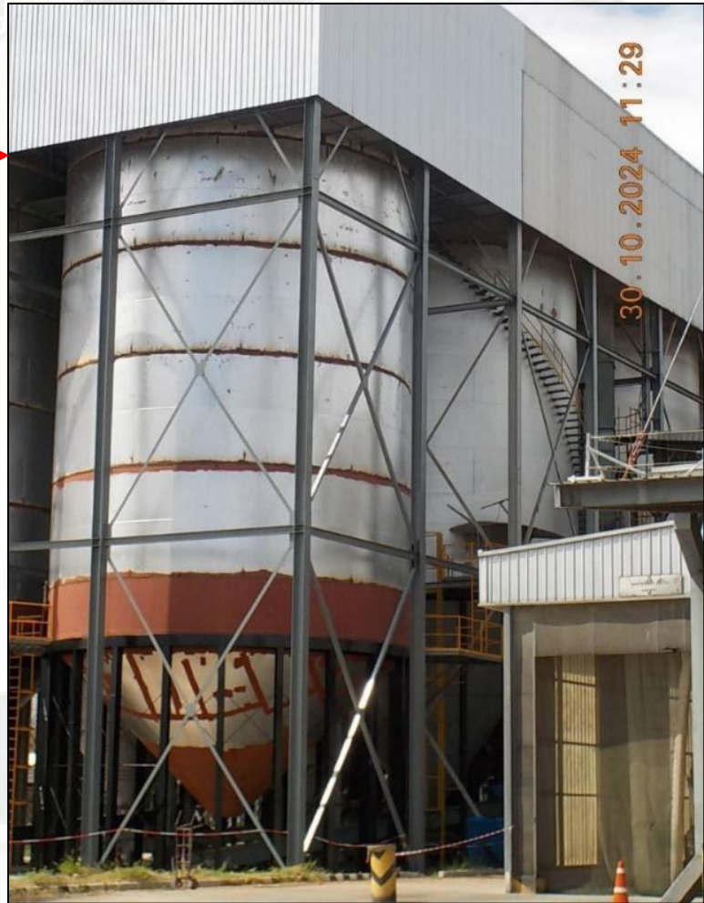
ภาพที่ ๕ สถานที่ก่อสร้างไซโลร่าสกัดน้ำมัน ที่เกิดอุบัติเหตุ
