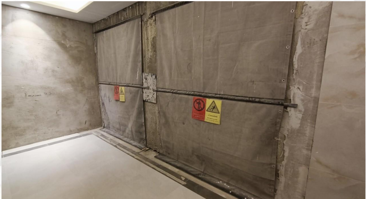
รูปแสดงการติดตั้ง Protection และป้ายเตือนอันตราย
