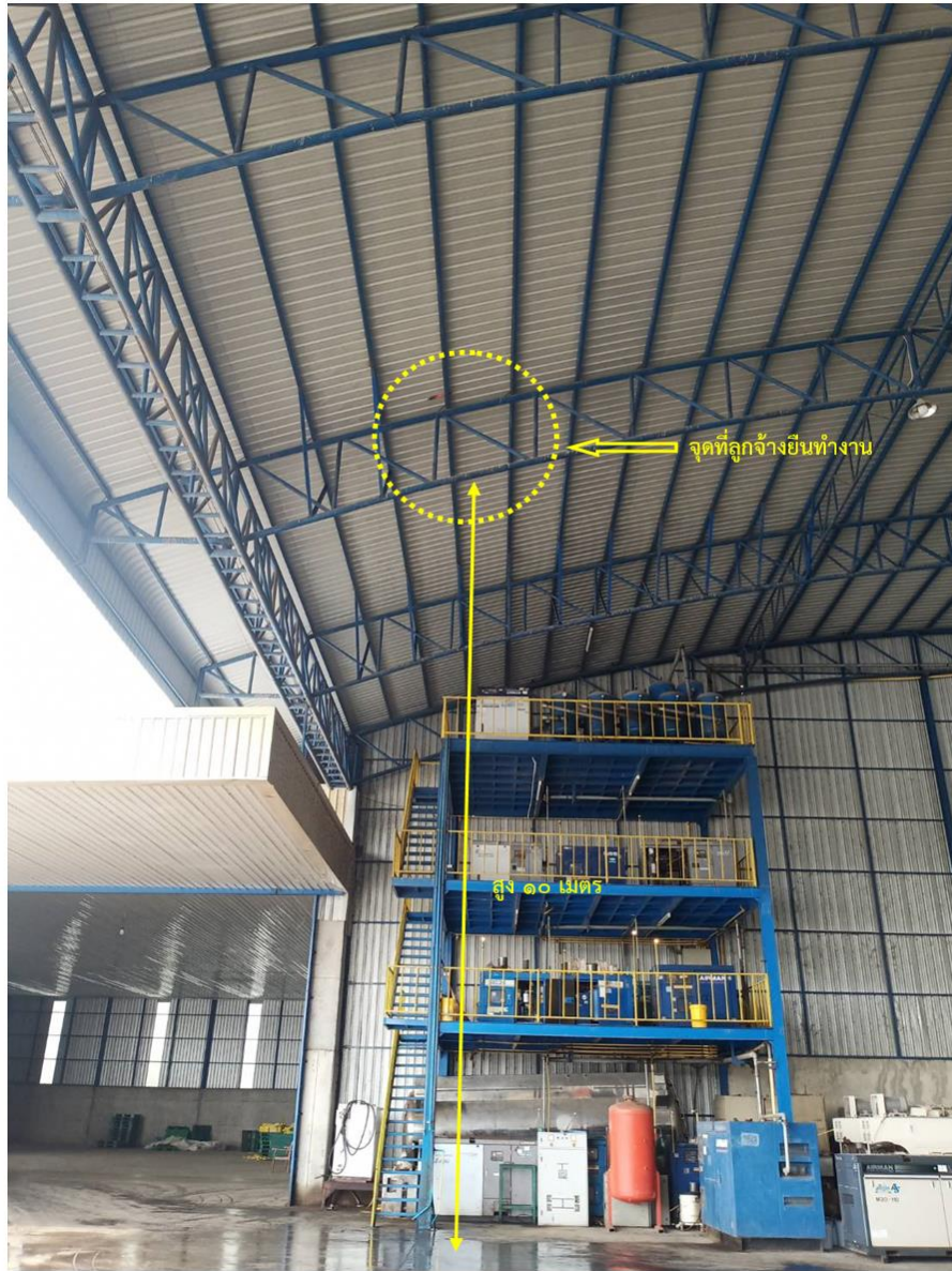
รูปที่ ๒ แสดงลูกจ้างได้ทำงานเชื่อมเสริมเหล็กอยู่บนโครงสร้างของคานตัวที่ ๒๘
