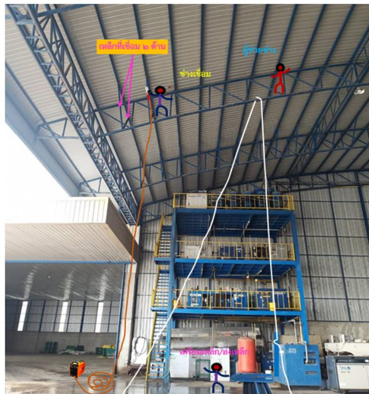
รูปที่ ๑๐ แสดงจุดที่ลูกจ้างทั้ง ๓ คน ปฏิบัติงานเชื่อมเหล็กเสริมความแข็งแรงของโครงสร้างหลังคาก่อนเกิดเหตุ
