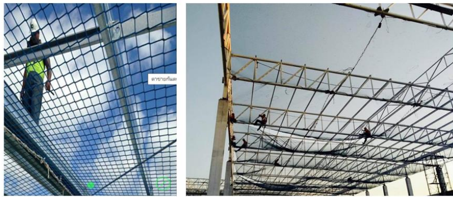
รูปที่ ๑๕ แสดงการติดตั้งตาข่ายกันตก/ตาข่ายนิรภัย
