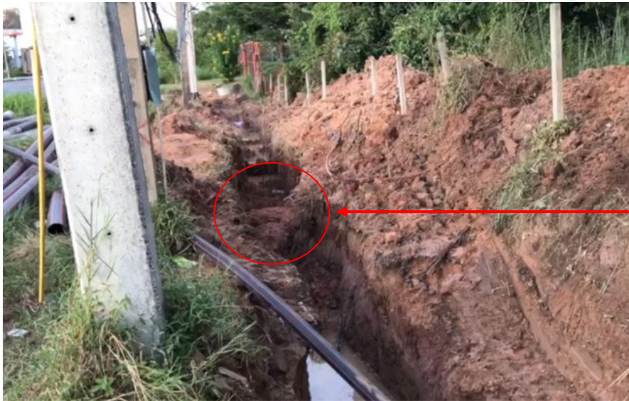
รูปที่ ๒ จุดเกิดเหตุที่ดินพังทลายลงมาทับคนงาน
