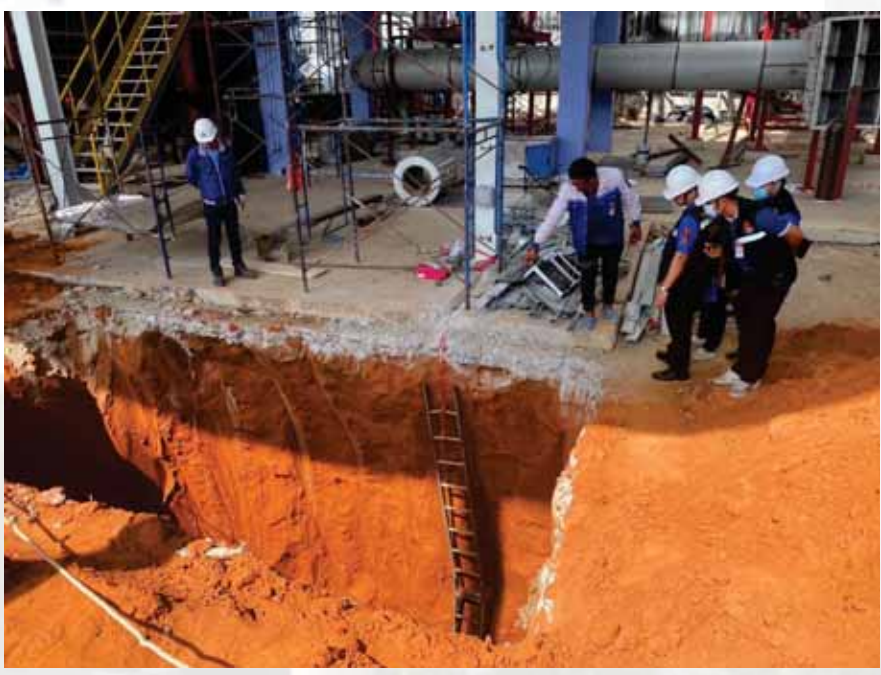
ภาพการติดตั้งบันไดเพื่อให้ลูกจ้างลงไปปฏิบัติงาน
