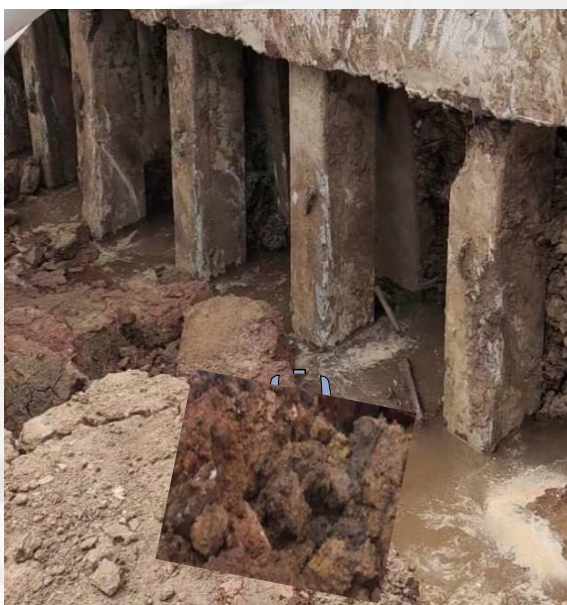
ดินพังทลายที่บนนายธรรมรงค์ฯ กระแทกกับเสาเข็ม
