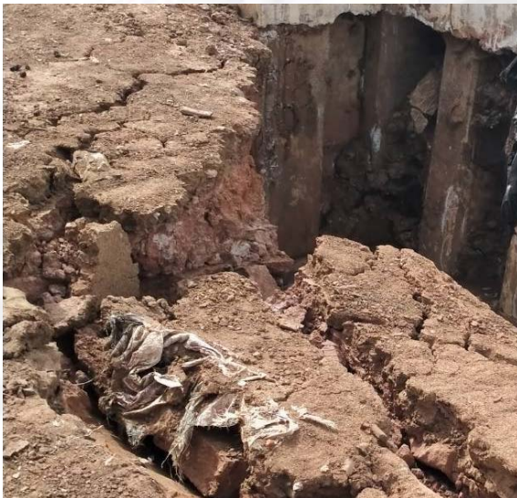
ดินบริเวณขอบด้านในร่องที่ขุดได้เกิดพังทลายลงมา
