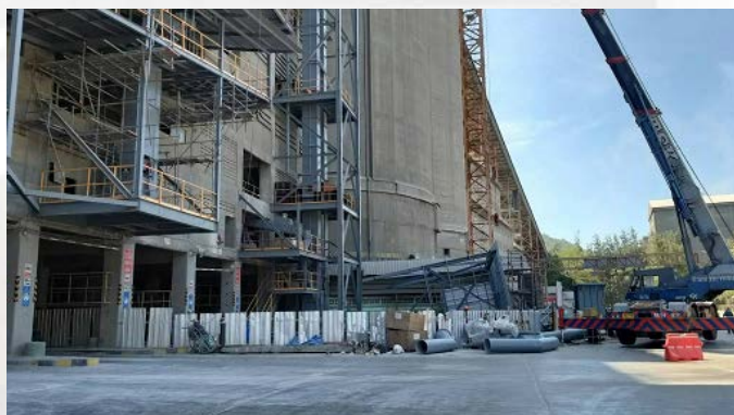
รูปที่ ๑-๑ แสดงสภาพอาคารจ่ายปูนซีเมนต์ผง (ไซโลหมายเลข ๑๘) สถานที่เกิดอุบัติเหตุ
