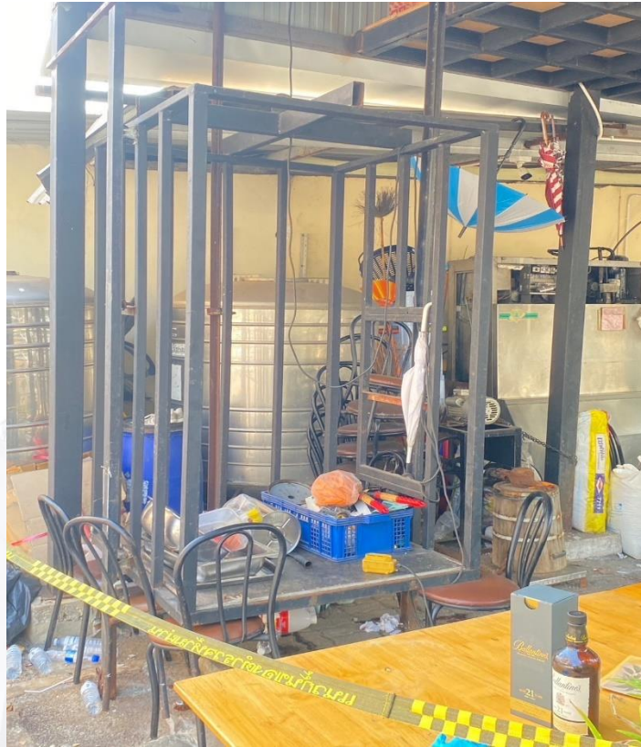
รูปที่ ๒ ลักษณะลิฟต์ขนส่งวัสดุที่เกิดเหตุ
