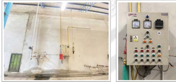
ภาพ : ระบบควบคุมห้องอบไม้
